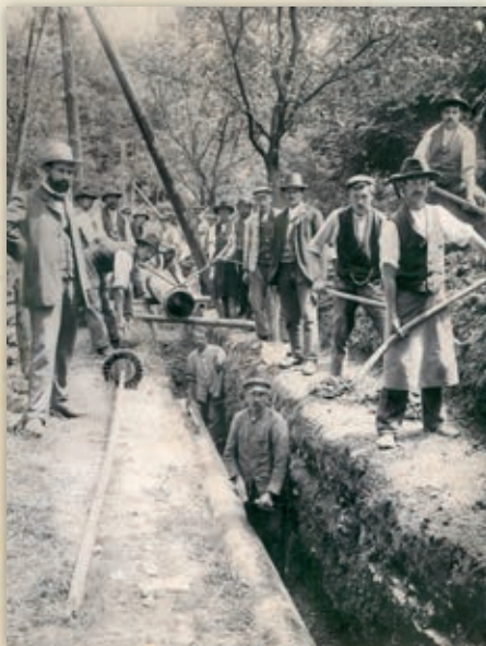
»WASSER MARSCH!« hieß die Devise beim Wasserleitungsbau anno 1906 im Jenaer Mühlental – »Wasser marsch!« lautet auch der Name der neuen Ausstellung im Jenaer Stadtmuseum
